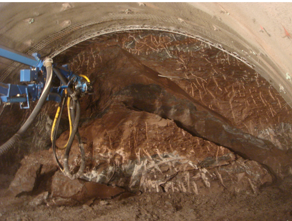
Abb. 10: Station [m]: 639,6 Hütteldorf-Formation: großer Ausbruch in der Ortsbrust (Blickrichtung: Südost). Die geringere Stabilität der Ortsbrust innerhalb der Hütteldorf-Formation ergibt sich durch die hochgradige tektonische Zerlegung mit engständigen Harnischflächen, die, insbesondere bei ungünstiger Schicht- und Harnischlage, zum Ausbrechen neigen (Trennflächen (Azimut/Dip): Schichtflächen 260/10, Harnisch 1 280/50, Harnisch 2 290/65, Störung 195/30; M. Sapp, Büro Bechthold).
